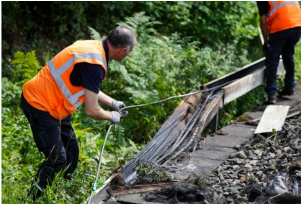
In Düsseldorf wurde neben der Bahnstrecke Feuer in einem Kabeltunnel gelegt, der sechs Kabel in Mitleidenschaft zog
