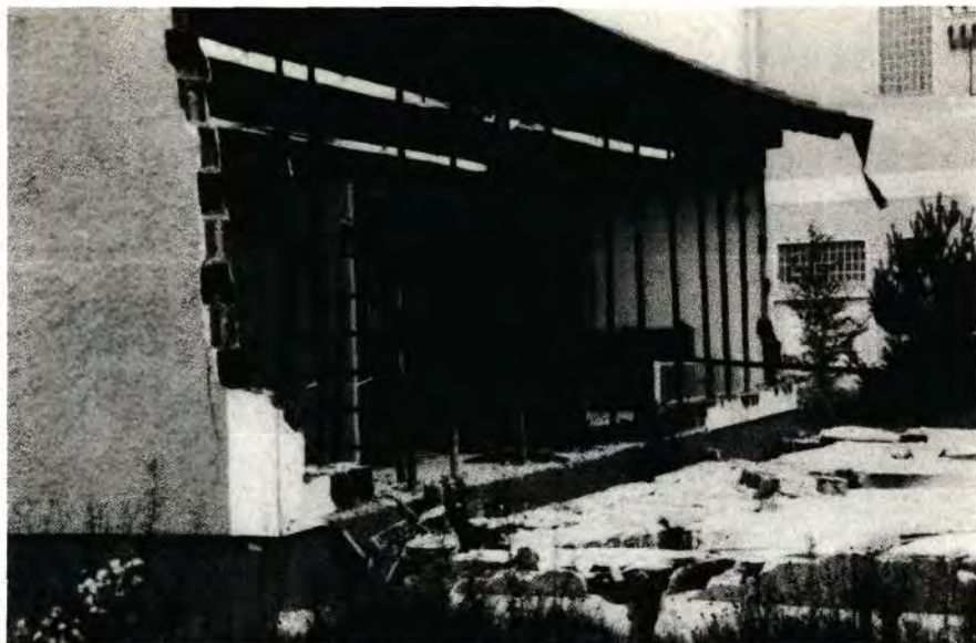
Brandanschlag auf ein Umspannwerk der Ostbayerischen Energieversorgung (OBAG) in Wackersdorf am 18. 9. 87
